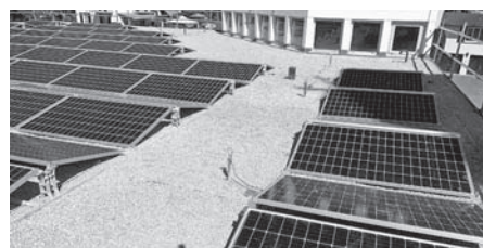
Photovoltaikanlage mit Chor der Kirche.
